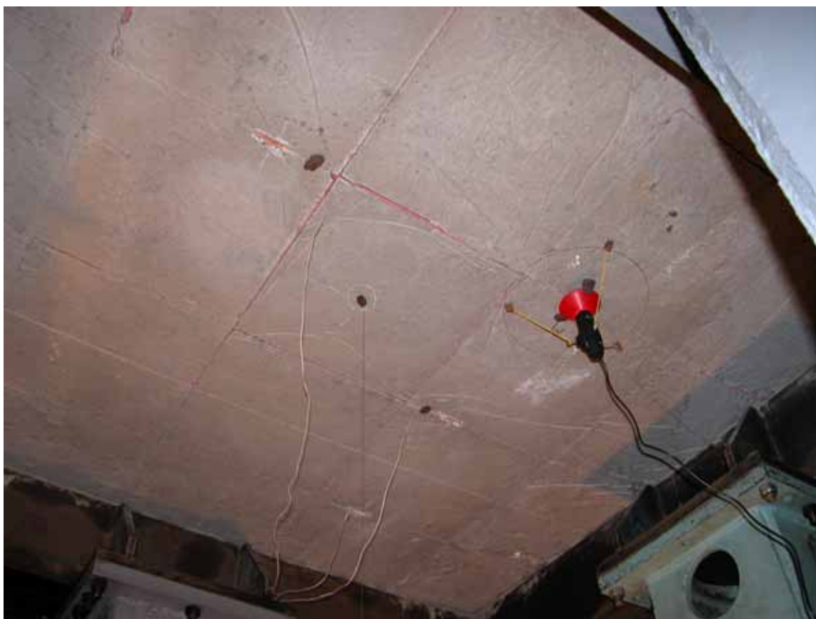
Рис. 3.18 – ФПП-1 (М2) на испытательном стенде после разрушения. Вид снизу
